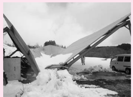
被害を受けた堆肥舎
