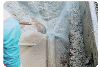
漏水のようす
