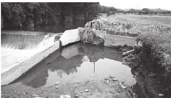
大きく破損した水路の取水堰
