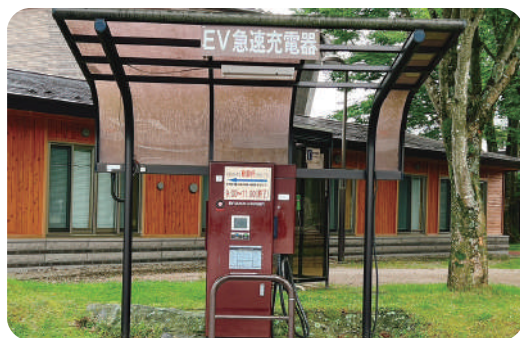
友愛の森に設置されているEV急速充電器
