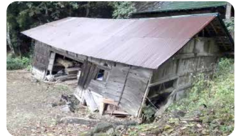
倒壊の恐れ「キケン」
