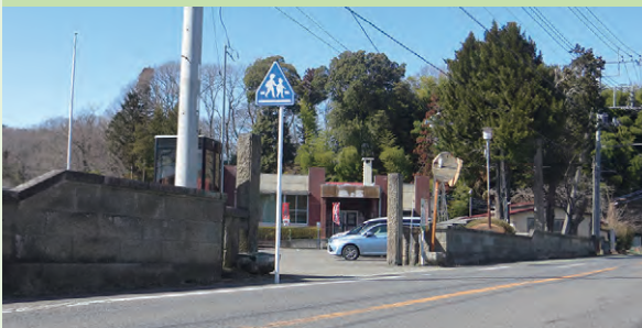
芦野支所入口の石塀は一部解体され再設置工事を実施
