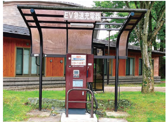
道の駅那須高原友愛の森に設置されたEV急速充電器
