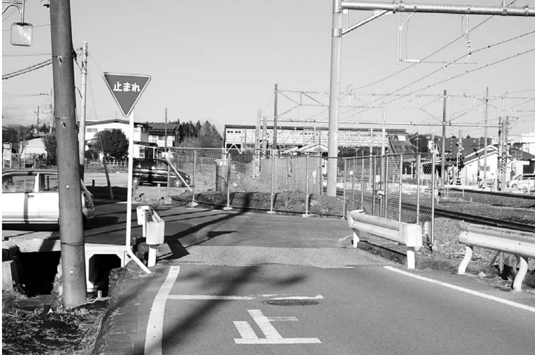
通学路であり早急な改修が望まれる金井蛇橋
