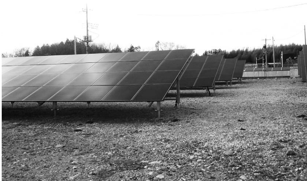
自然エネルギーの太陽光発電
