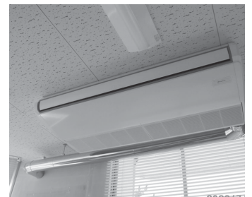
学校に設置されたエアコン
